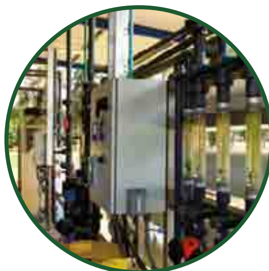
Planta de Tratamiento de Agua
